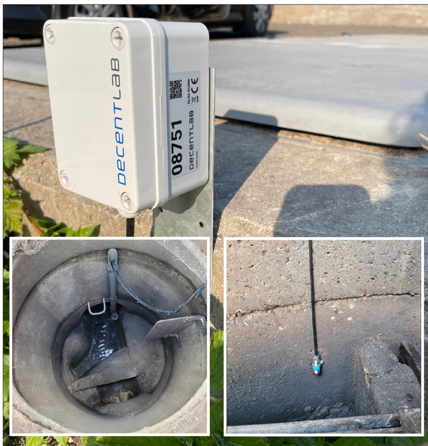
Figur 2. Eksempel på IoT logger til monitoring af overløb fra kloak. Loggeren er batteridrevet og data sendes til NIRAS' varslingsserver, hvor de behandles i henhold til de konkrete forhold ved badeområdet.
