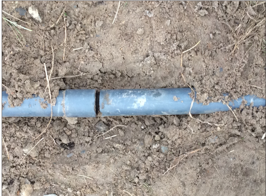
FIGUR 2: Eksempel på ledningsbrud, her i et drikkevandsrør.
