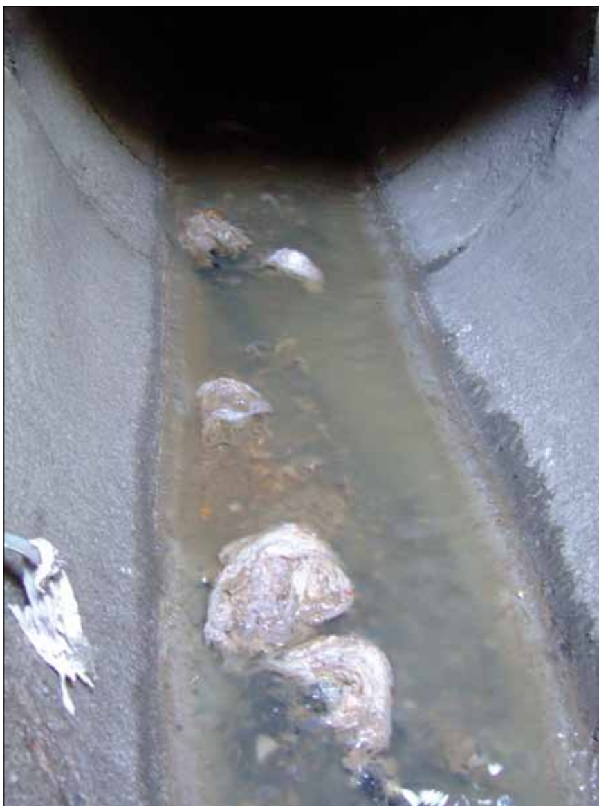
Figur 2. Akkumuleret kloaksediment i et fællesledning placeret umiddelbart opstrøms for et overløbsbygværk.
