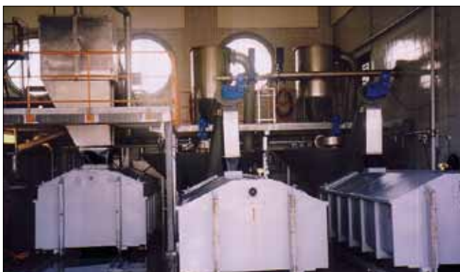
Foto 3: Container til opsamling af ristegods på Renseanlæg Lynetten. Ristegodset lugter dårligt og opsamles derfor i en bygning hvor man kan forhindre ildlugt i at genere omgivelserne. Ristestof udgør 3-4 l/år/personequiv. Hvis man vil undgå ristestof kan man installere en comminutor, som er en slags stor køkkenkværn. Den funder ristestoffet så det fortsætter ind i anlægget og bliver opsamlet som en del af den almindelige slamproduktion. Ristestof der fanges i risten kan deponeres på losseplads eller brændes på selve rensningsanlægget/1/. (Foto: Aquafoto, København)
