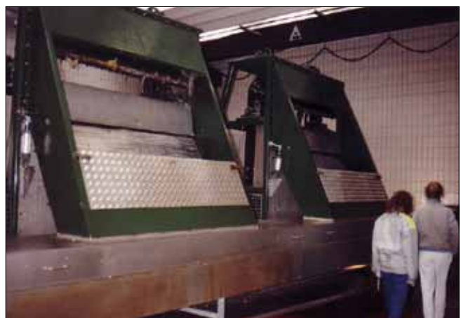
Foto 2: På større rensningsanlæg er ristene indkapslet for at mindske lugtgener og mågegener (måger kan snuppe ristemateriale og droppe det i omegnen af rensningsanlægget). Det er ikke morsomt at få tæppebombet sin have med gamle klude, tamponer, døde rotter osv. Her er ristanlæg på Avedøre Kloakværk (Foto: Aquafoto, Danmark).
