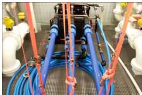
Figur 6. Test-rig opstillet på Lysholt Vandværk med 3 opgravede rør og 1 nyt PE rulle.
