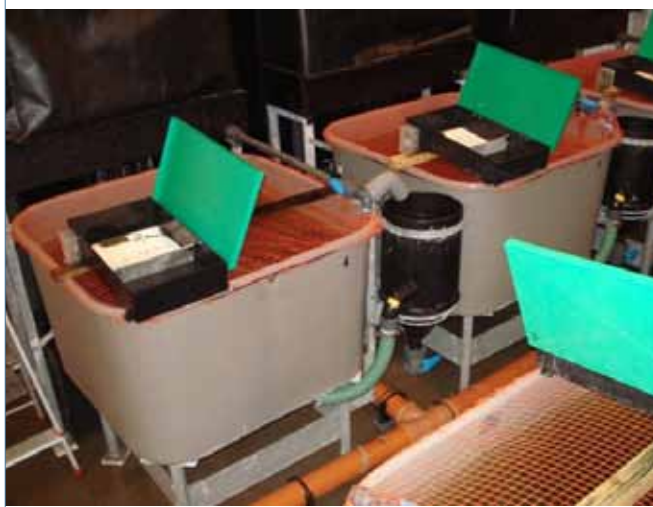
Figur 1. Fiskeopdræt i recirkulationsanlæg. Pilotanlæg ved DTU Aqua i Hirtshals. De kubiske grå tanke er fiskekarrene med ørreder. De grønne kasser ovenpå dosererer foder til fisketanken. De sorte kolonner på øverste billede er biofiltrene. Dagligt udskiftes < 5 % vand.
